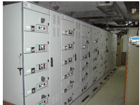
Face B (TGBT installé sur site)
