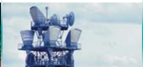
Télécom réseau UMTS
