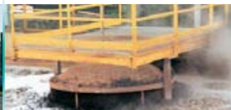
Traitement des eaux
